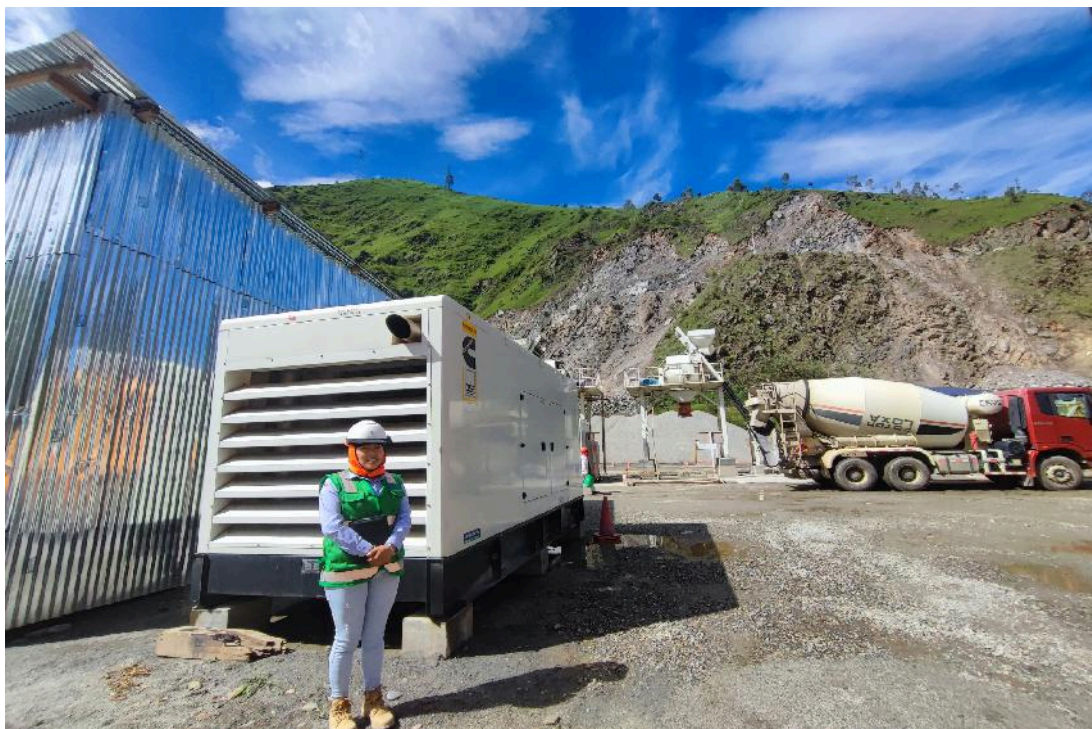
Figura 08: Grupo electrógeno que abastece a la planta industrial concretera
