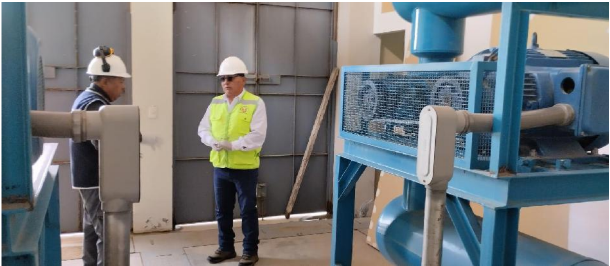
Fotografía 02. Compresores Sala de Sopladores
