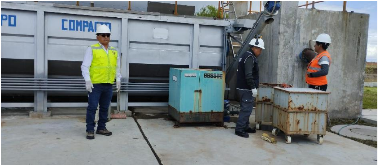
Fotografía 04. Equipo compacto separador de residuos sólidos, arenas y grasas.
