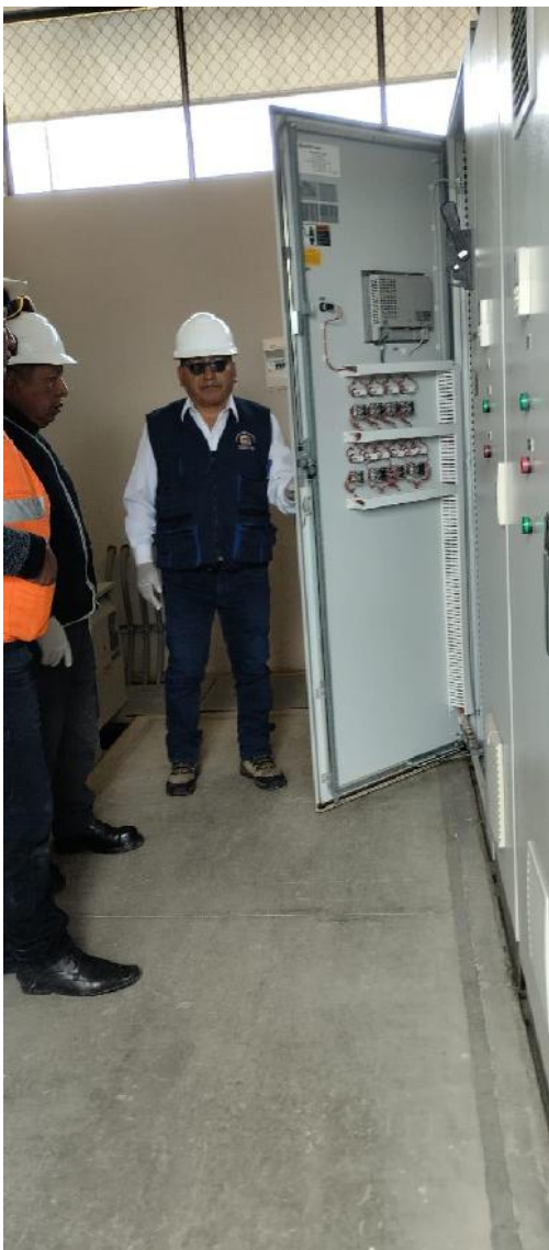
Fotografía 05. Sala de tableros
