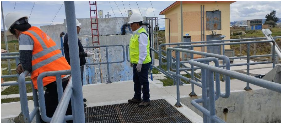
Fotografía 20. Bombas sumergibles que extraen lodo
