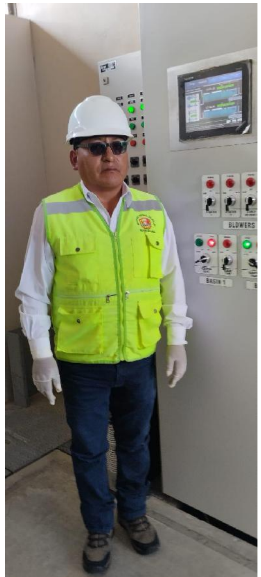
Fotografía 06. Sala de tablero Automático
