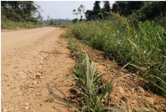
Falta de cunetas en el camino
