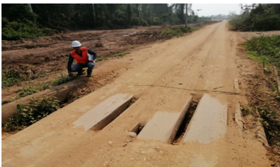
Alcantarilla artesanal con falta de mantenimiento
