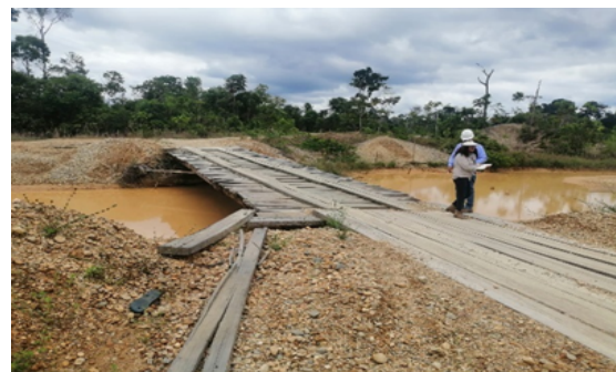
Puente artesanal deteriorado
