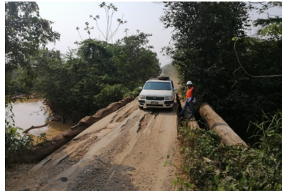
Puente artesanal deteriorado
