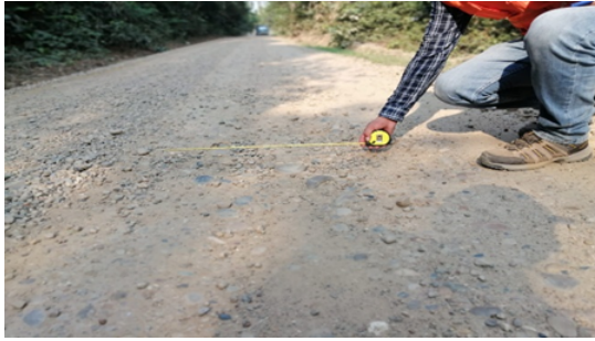
Camino deteriorado con presencia de baches
