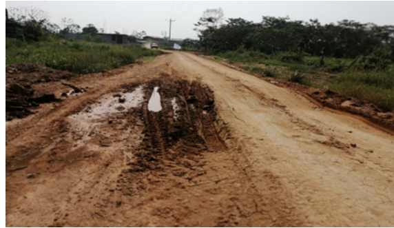
Presencia de ahuellamientos
