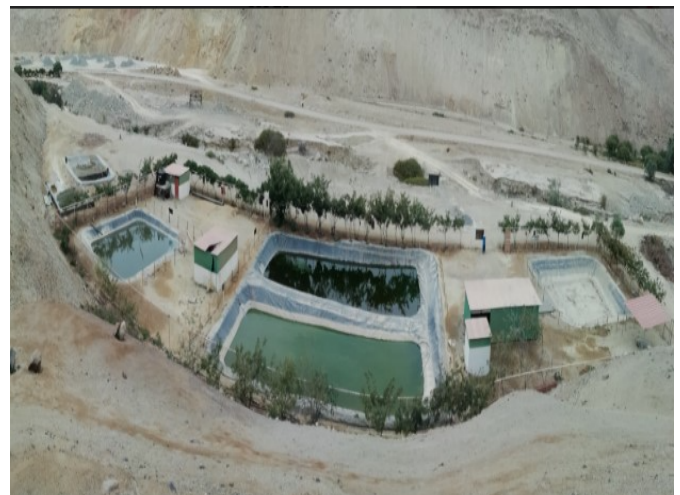
Fig. N° 27 PTARD después de la optimización
