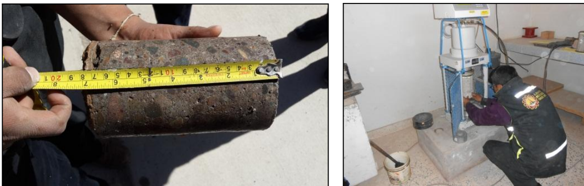
Figura 10: Fotografías donde se aprecia la verificación del espesor del pavimento y la rotura de testigos de concreto del pavimento rígido
