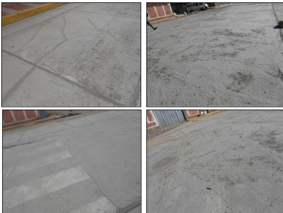
Figura: 08: Fotografías donde se puede apreciar las fallas que existen en el pavimento rígido
