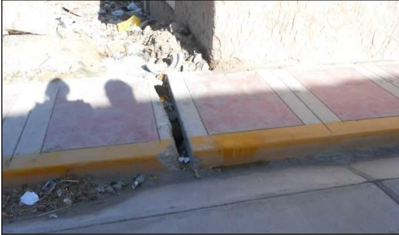
Figura 05: Fotografía donde se aprecia los daños a la vereda
