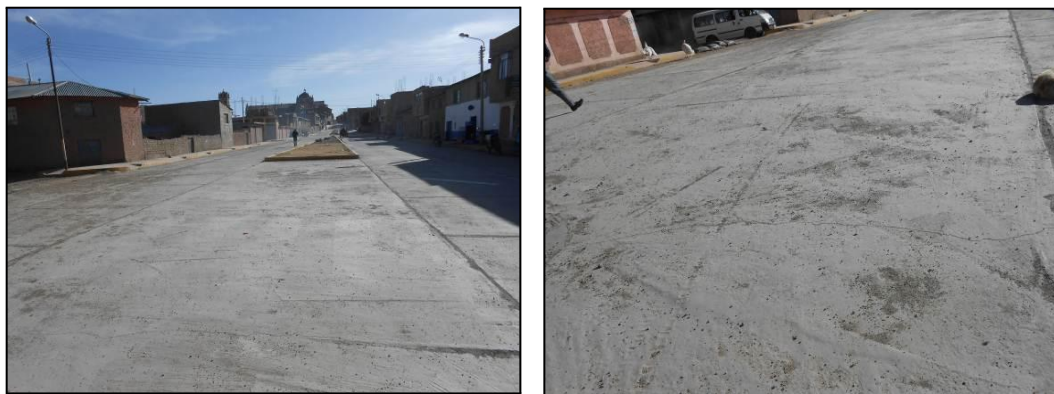
Figura 03: Fotografías de las losas del pavimento rígido sin juntas de dilatación
